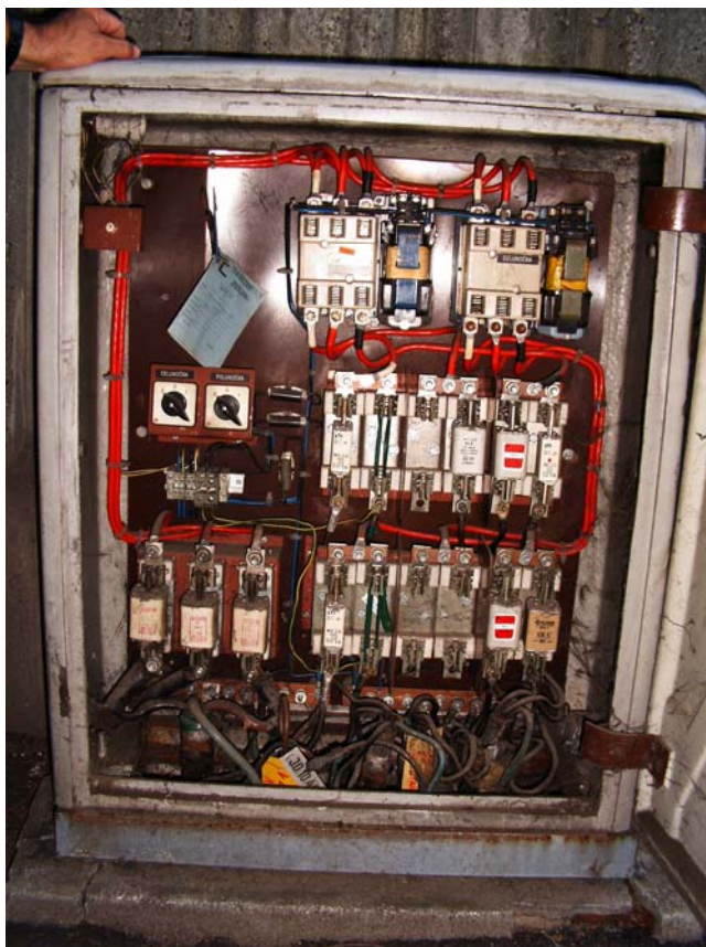
Slika 2. Unutrašnji izgled razvodnog ormana tipa ROR–6P
